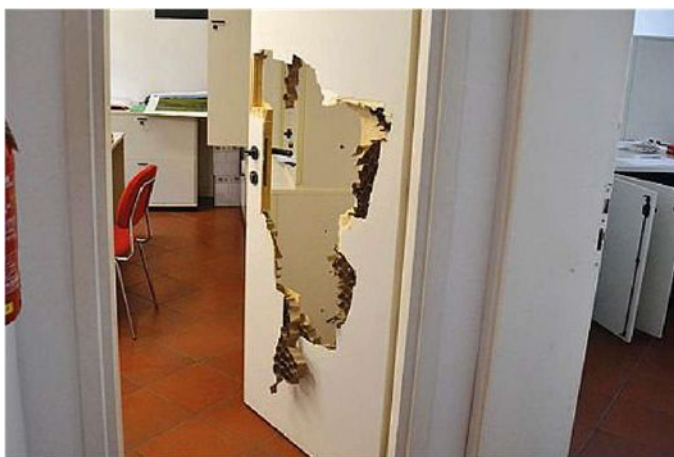
La porta sfondata dell'ufficio amministrativo dell'azienda agraria Servadei
