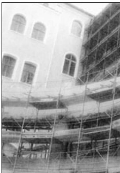
Un'immagine del cantiere aperto dalla Camera di commercio per la realizzazione del nuovo «Conference»
