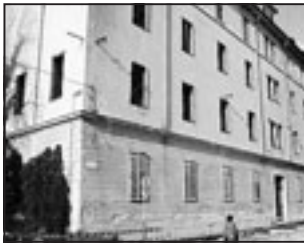
L'edificio pericolante dell'ex Locchi
