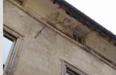
Ex sede Uniurb, crollano parti di cornice
