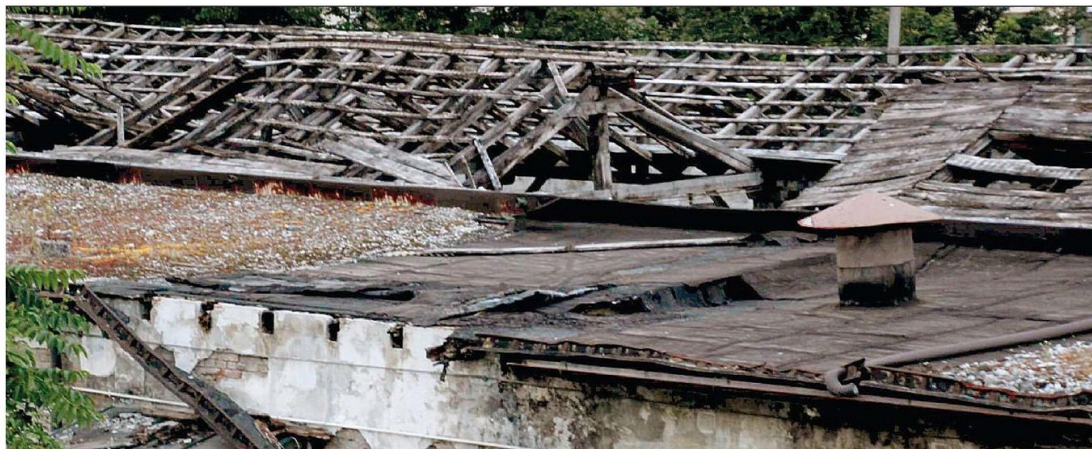
Ecco come appare oggi l'ex rimessa dei tram: una struttura totalmente scoperchiata dopo la rimozione dell'amianto (foto Bumbaca)
